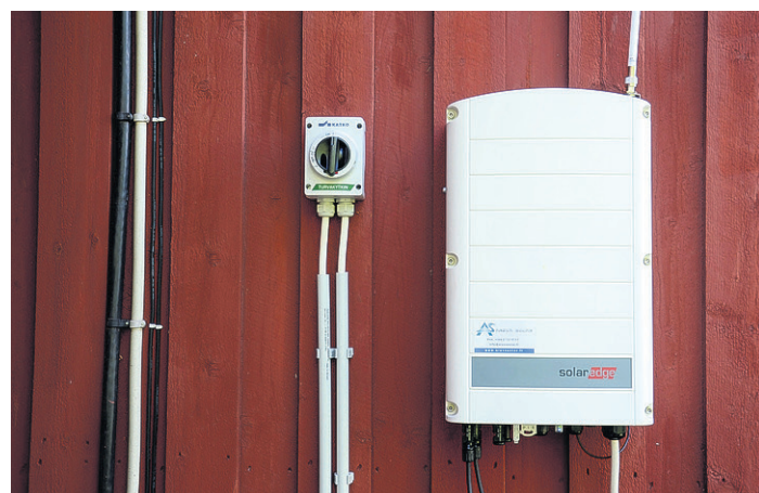
Invertteri hallin seinässä muuntaa sähkön vaihtovirraksi.
